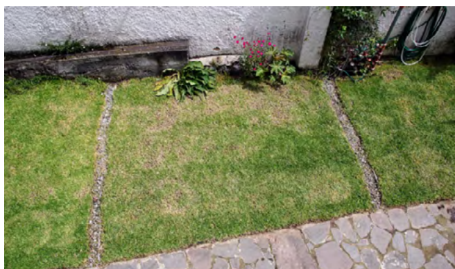
Figura 19. Sistema de infiltración, Casa Armero (YES Innovation, 2019).
